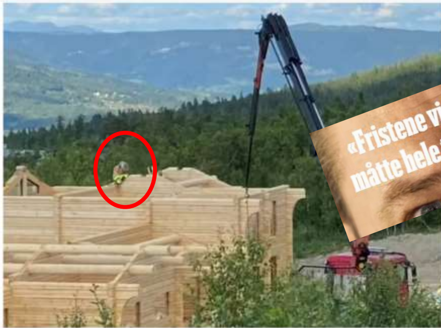
Her jobber en ansatt sikker med motorsag på entreprenøroppen Kari Johannes Saarisilta hytteprosjekt på Gæilo. «Overbergensle fare for liv og helse», mener Arbeidstilsynet. Foto: Arbeidstilsynet
