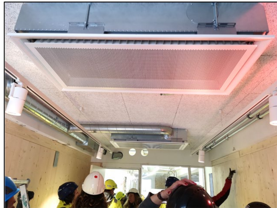
Bafler ferdig montert i prøverom i KA13. Foto: Christoffer Siopan Engtrø
